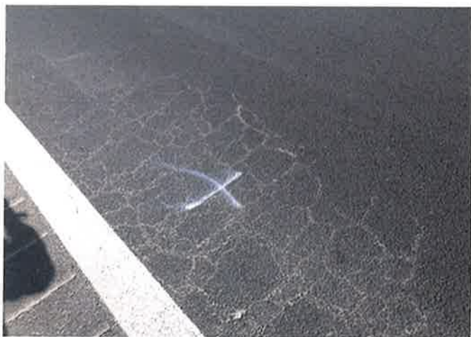
舗装損傷写真
