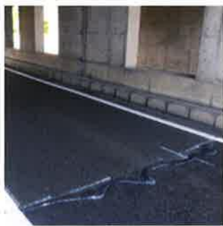
舗装損傷現況
