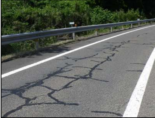
舗装損傷状況
