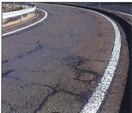
舗装損傷状況(イメージ)
