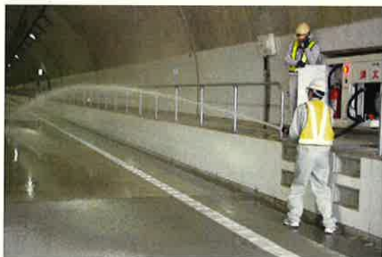
▲消火栓設備点検イメージ
