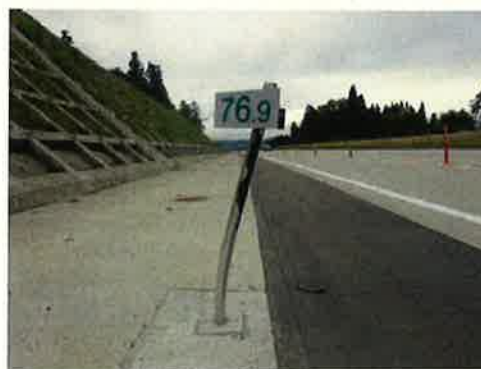
▲道路施設損傷イメージ
