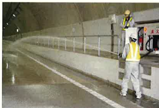
▲消火栓設備点検イメージ
